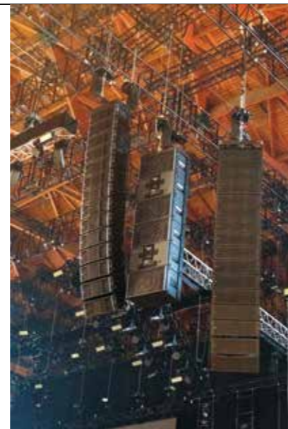
9150 - Un lato dell'impianto PA Meyer.
