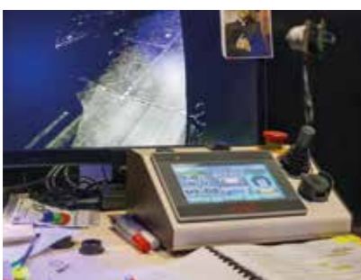
Comando delle automazioni.
