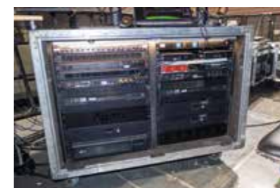
Rack con il processore L-ISA.
