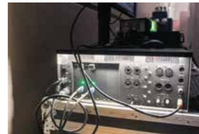
La prima cosa che salta all'occhio guardando il retro dei server di Disguise sono la luce a LED e i connettori audio XLR, piccoli particolari che rendono evidente l'attenzione maniacale per i dettagli dell'azienda inglese nella realizzazione di macchine appositamente concepite per il mercato professionale.
