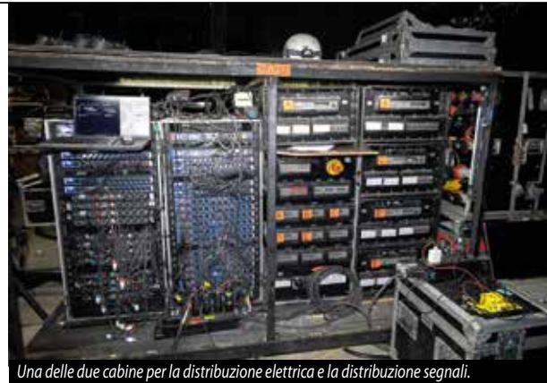
Una delle due cabine per la distribuzione elettrica e la distribuzione segnali.
