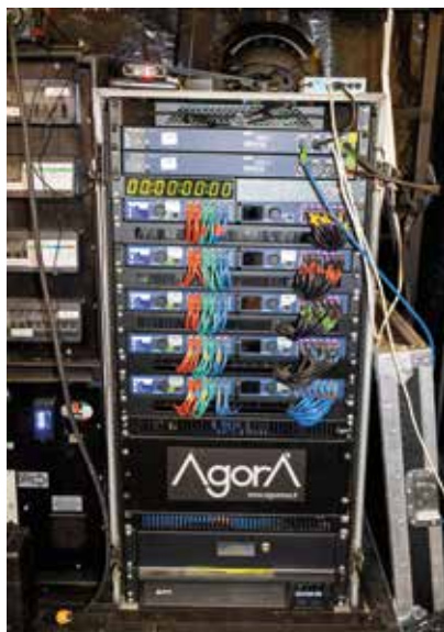
Uno dei rack del sistema Luminex.
