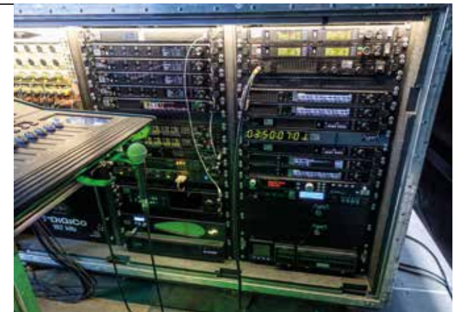
Rack outboard sul palco.
